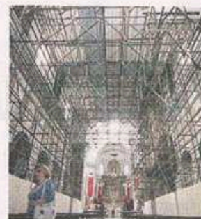
La navata Impalcature in ferro nascondono il soffitto del '600
